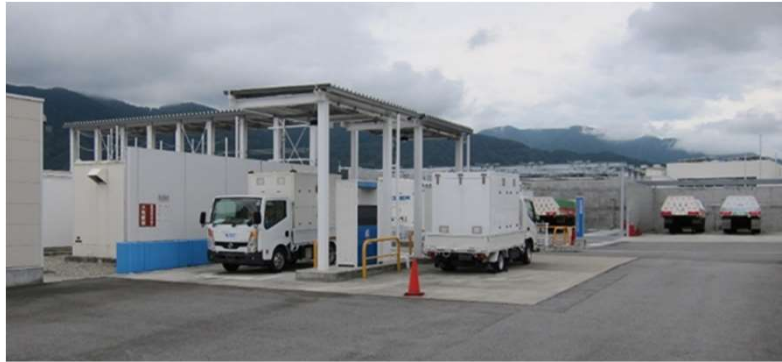
図13 水素出荷施設の水素供給設備
