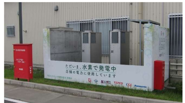
図17 オギノ向町店の店舗裏に設置されたPanasonic製の燃料電池2台
