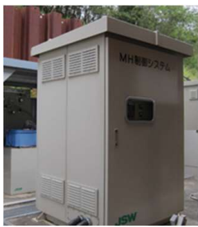
図10 水素発生装置用電源
