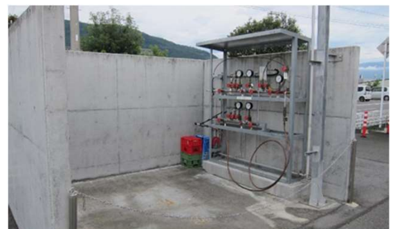
図18 オギノ向町店の店舗裏に設置された燃料電池に水素を供給するためのカードル置き場
