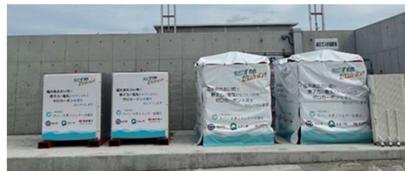
図5 水素ステーション裏側のカードル置き場
