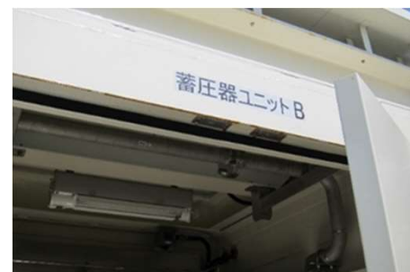
図23 高圧水素ガス容器が納められた蓄圧器ユニット
