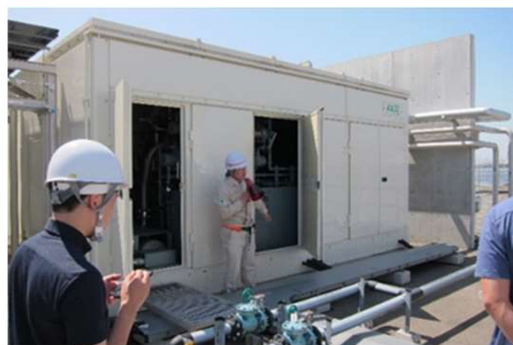
図22 水素昇圧設備
