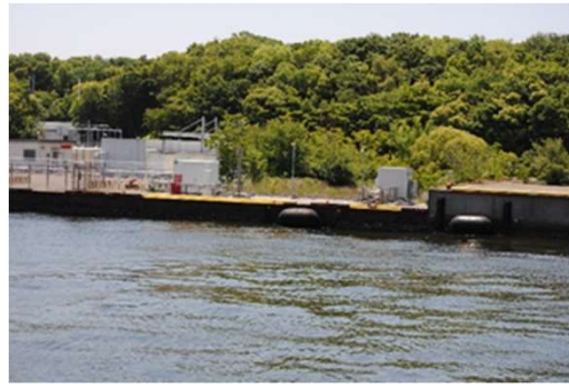
図10 海側から見た関西電力南港発電所内のバンカリング設備
