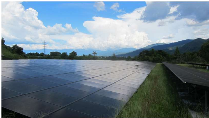
図2 山梨県甲府市の米倉山の大規模太陽光発電所の一部（図8の①）
