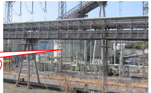
図3 バイオマスサイロ
